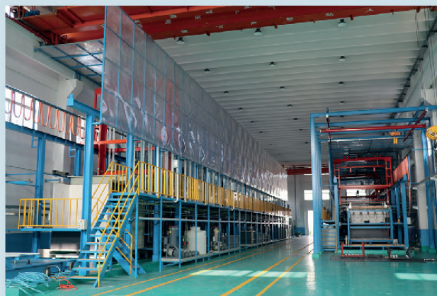
Производственная линия для хромирования гидроцилиндров
