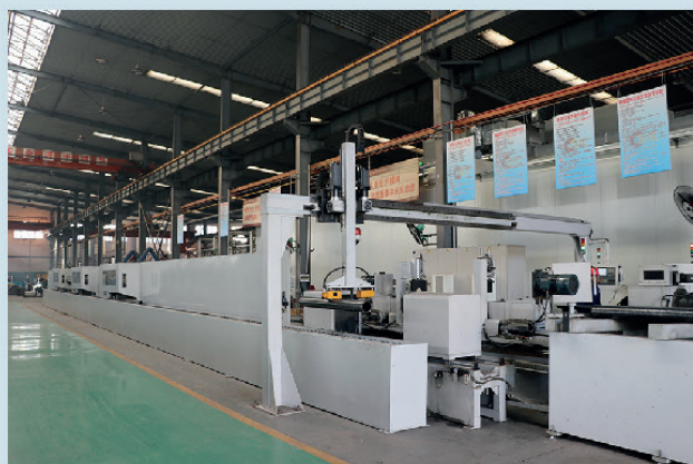
Автоматическая линия порезки трубы
